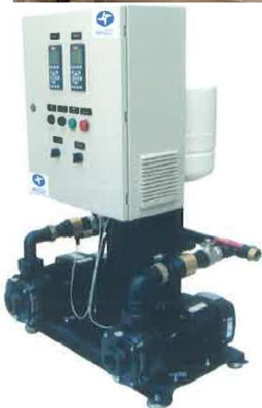
BOMBA DE INCÊNDIO (AO LADO DO RESERVATÓRIO SUBTERRÂNEO)
